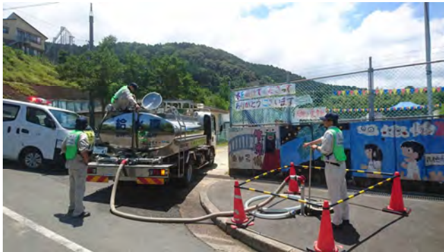
★★★プールのフェンスに注目★★★ 7月23日 消火栓から充水（天神小学校前消火栓）
